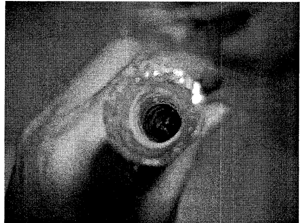
写真1 b. 電磁石電源の冷却水パイプに詰まった黒色の固形物
